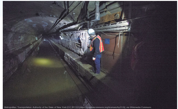
▲ 圖7 紐約地鐵隧道淹水(Hurricane Sandy, 2012)
