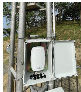
圖 8-f. LoRa 終端無線收集主機安裝照片
