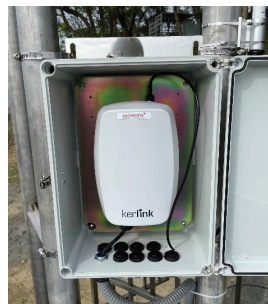
圖 8-e. LoRa 終端無線收集主機安裝照片
