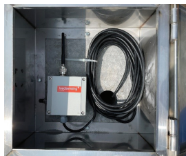
圖 8-b. 水壓計 LoR 記錄器安裝照片
