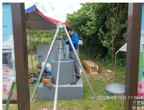
圖 4. 右邊通訊電纜端的作業人員，手握的機構為連接的彈簧設備，目的為吸收纜線與儀器端所造成的環境振動避震器單元。
