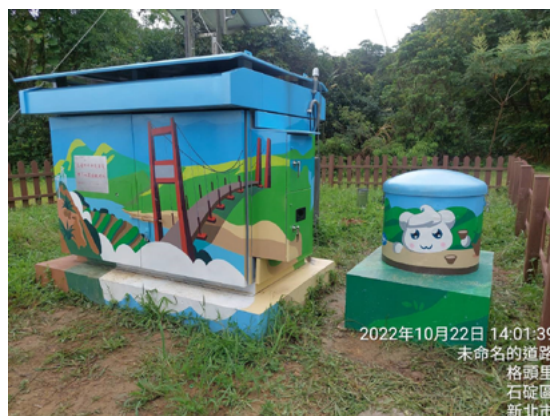
圖 3. 測站主要分成儀器屋 (左) 與井體 (右)，儀器屋配置地表收錄系統 (如可拔插記錄器以及 UPS 不斷電兼具防突波電源模組系統)，井體在地下配置地震儀系統。
