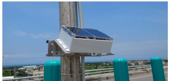
圖 6-b. NB-IoT 無線通訊與太陽能供電模組
